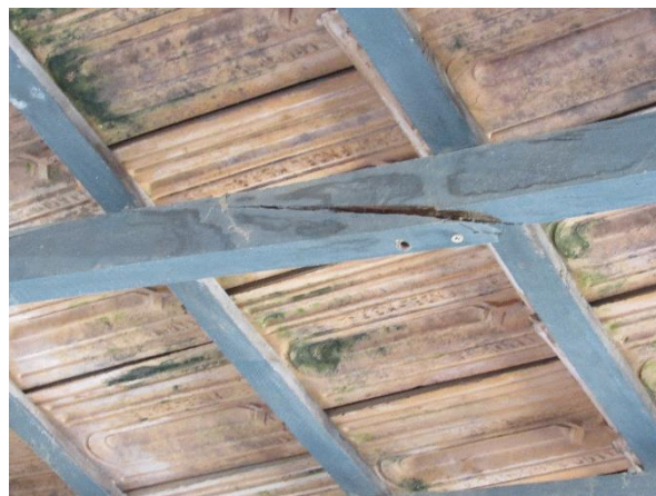
Foto 30: Detalhe de um das peças do engradamento em madeira da varanda exibindo rachadura. Autoria: Fabiane Cristine Fonseca. Janaúba, 18 de Outubro de 2018.
