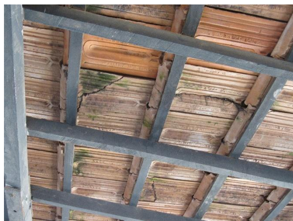
Foto 34: Detalhe de telhas danificadas na cobertura da varanda. Autoria: Fabiane Cristine Fonseca. Janaúba, 18 de Outubro de 2018.
