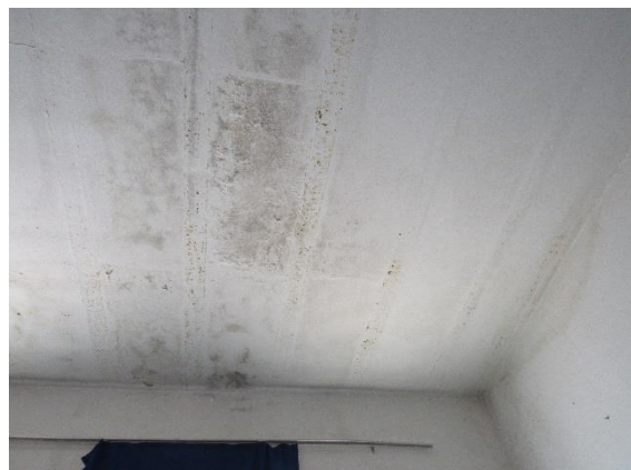
Foto 36: Mancha de umidade observada na laje da sala de informática. Autoria: Fabiane Cristine Fonseca. Janaúba, 18 de Outubro de 2018.
