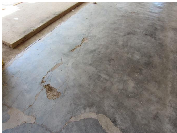
Foto 29: Detalhe do piso em concreto queimado apresentando trincas, perdas e recomposições realizadas em material espúrio. Autoria: Fabiane Cristine Fonseca. Janaúba, 18 de Outubro de 2018.
