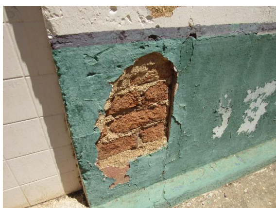
Foto 39: Perda do reboco identificada no embasamento da fachada frontal. Autoria: Fabiane Cristine Fonseca. Janaúba, 18 de Outubro de 2018.
