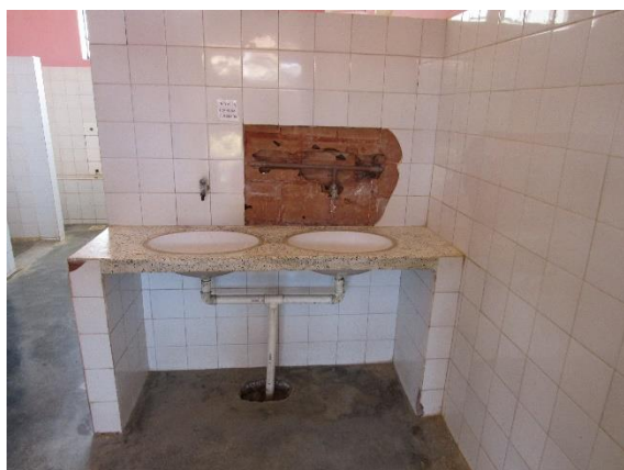
Foto 37: Vista do banheiro feminino apresentando perda de parte da alvenaria em função de intervenções inacabadas. Autoria: Fabiane Cristine Fonseca. Janaúba, 18 de Outubro de 2018.
