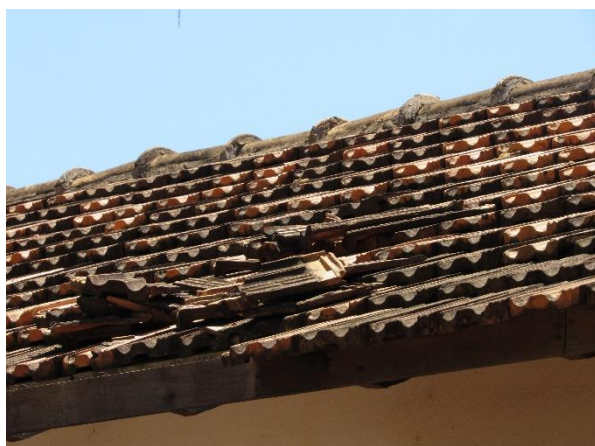
Foto 33: Telhas soltas no manto de cobertura da edificação. Autoria: Fabiane Cristine Fonseca. Janaúba, 18 de Outubro de 2018.
