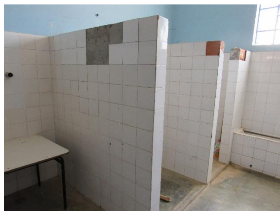
Foto 38: Vista de perdas no revestimento cerâmico das paredes do banheiro masculino. Autoria: Fabiane Cristine Fonseca. Janaúba, 18 de Outubro de 2018.
