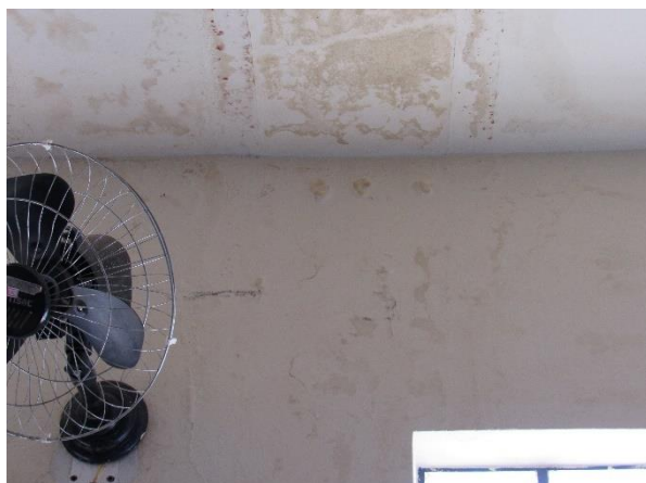
Foto 31: Detalhe de manchas de umidade presentes na laje e parede no interior da Biblioteca. Autoria: Fabiane Cristine Fonseca. Janaúba, 18 de Outubro de 2018.
