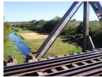
Ponte de ferro sobre o Rio Gorutuba, substituiu a que o rio levou. Foto: acervo blog "Onde o vento me leva"
