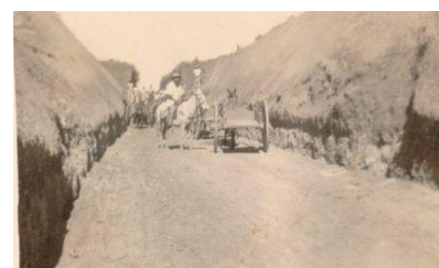
Escavação para construção da rede ferroviária em Janaúba Década de 40 – Foto: acervo de Aldemir de Souza Pires
