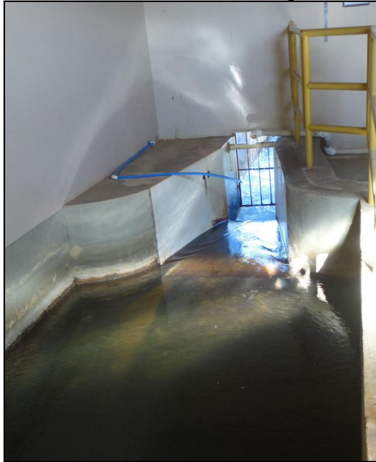
Figura 84 - Calha Parshall , Unidade de Tratamento de Água Bruta da ETA de Janaúba
