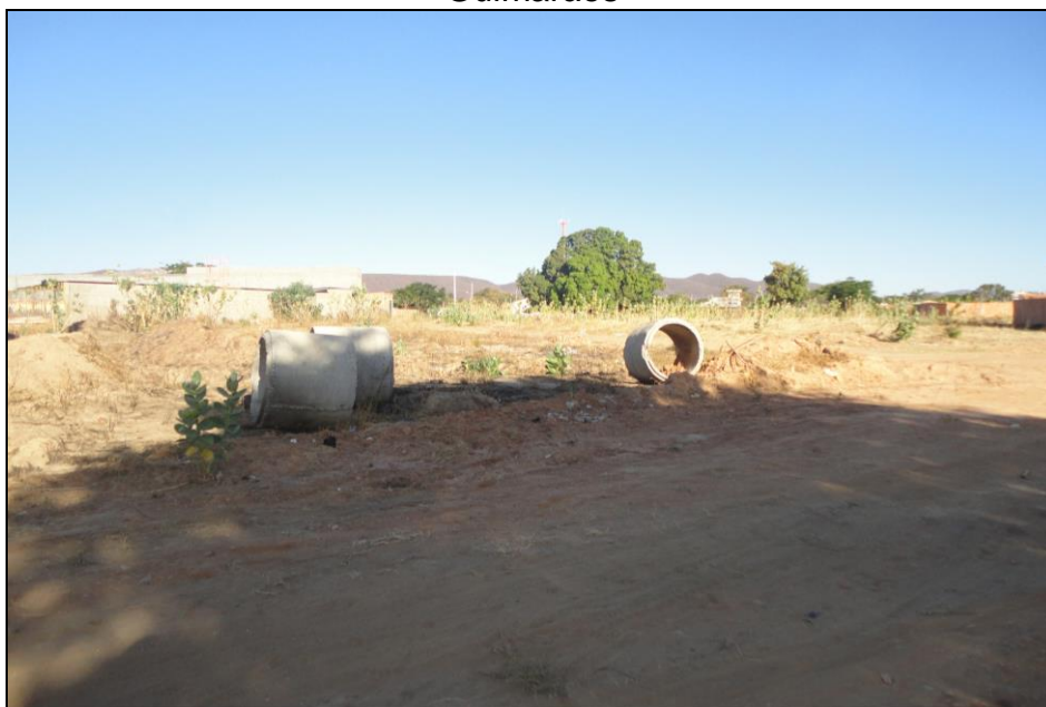
Figura 133: Obra de drenagem paralisada às margens da Avenida Edilson Brandão Guimarães
