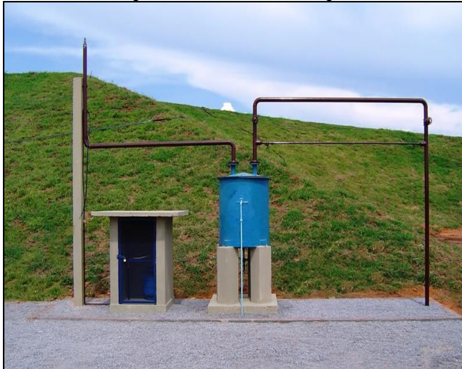
Figura 102: Queimador de biogás
