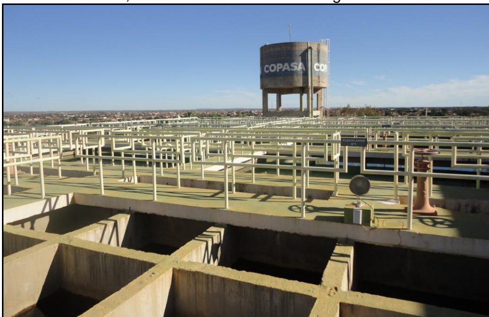
Figura 87 - Floculadores ,Unidade de Tratamento de Água Bruta da ETA de Janaúba
