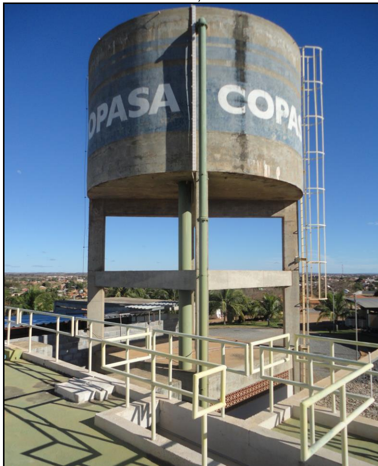
Figura 92 - Reservatório Elevado, localizado na ETA de Janaúba
