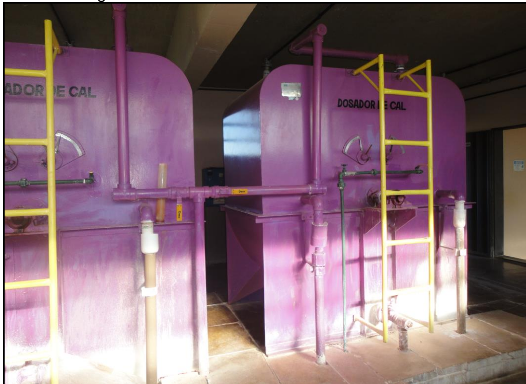
Figura 86 - Dosadores de Cal da ETA de Janaúba
