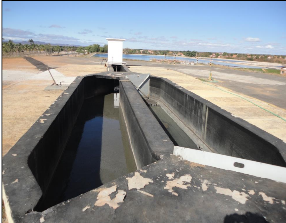
Figura 100: Tratamento Preliminar – Desarenador
