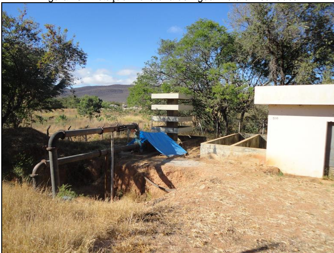
Figura 78 - Estação Elevatória de Água Bruta em Janaúba
