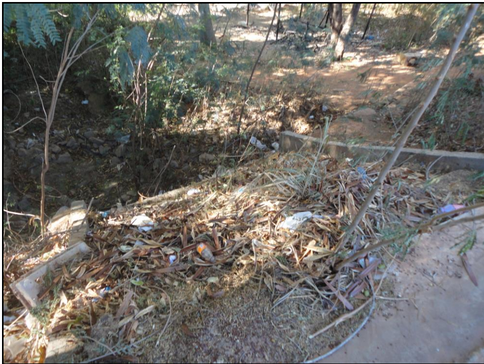
Figura 124: Descida de água pluvial da Avenida Edilson Brandão Guimarães
