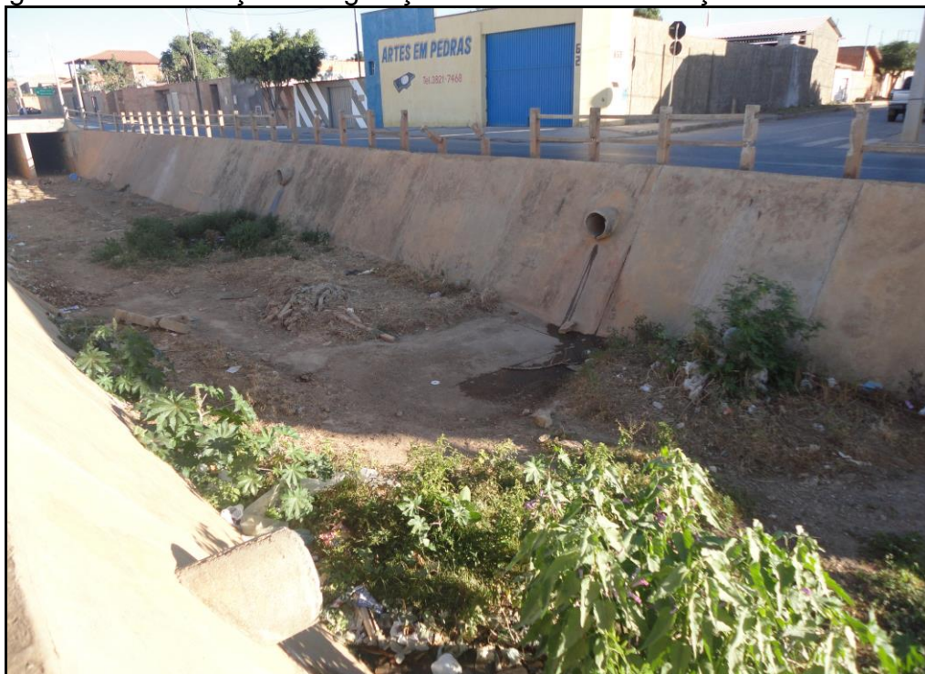
Figura 122: Presença de vegetação e falta de manutenção no canal aberto
