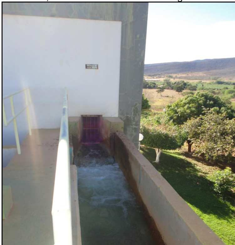
Figura 85 - Calha Parshall, Unidade de Tratamento de Água Bruta da ETA de Janaúba
