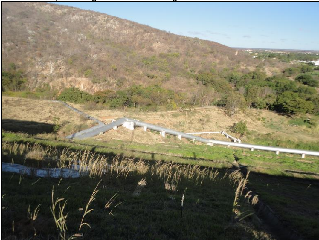
Figura 74 - Tubulação de Água Bruta na Barragem Bico da Pedra – Rio Gorutuba
