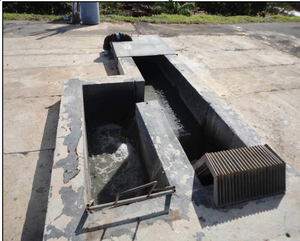
Figura 99 - Tratamento Preliminar – Chegada do Efluente e Gradeamento
