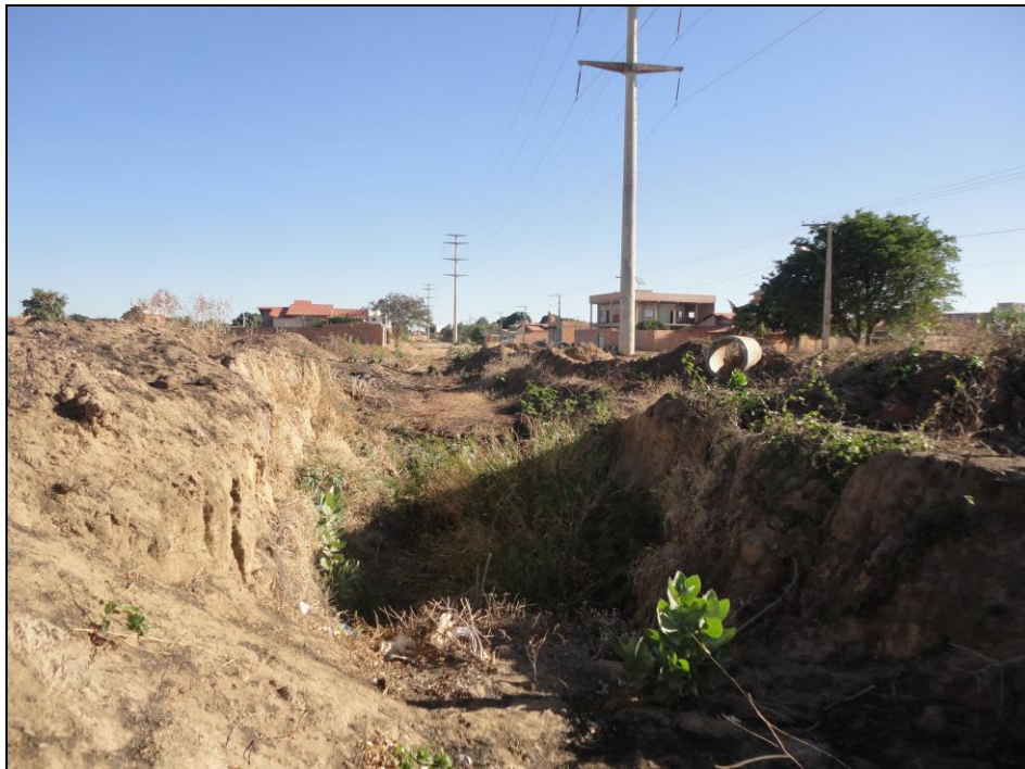
Figura 132: Obra de drenagem paralisada às margens da Avenida Edilson Brandão Guimarães
