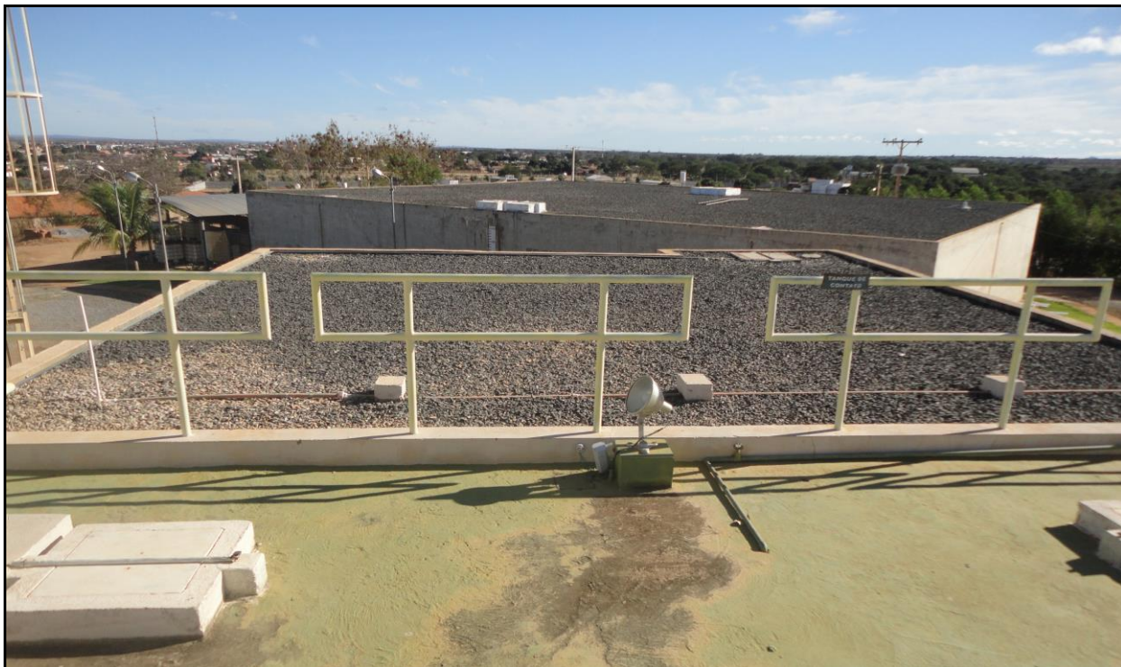
Figura 90 - Vista superior do Tanque de Contato, Unidade de Tratamento de Água da ETA de Janaúba
