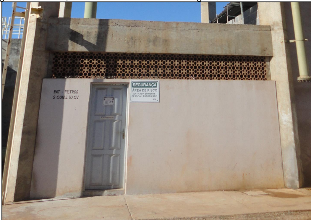
Figura 88 - Filtros, Unidades de Tratamento de Água Bruta da ETA de Janaúba
